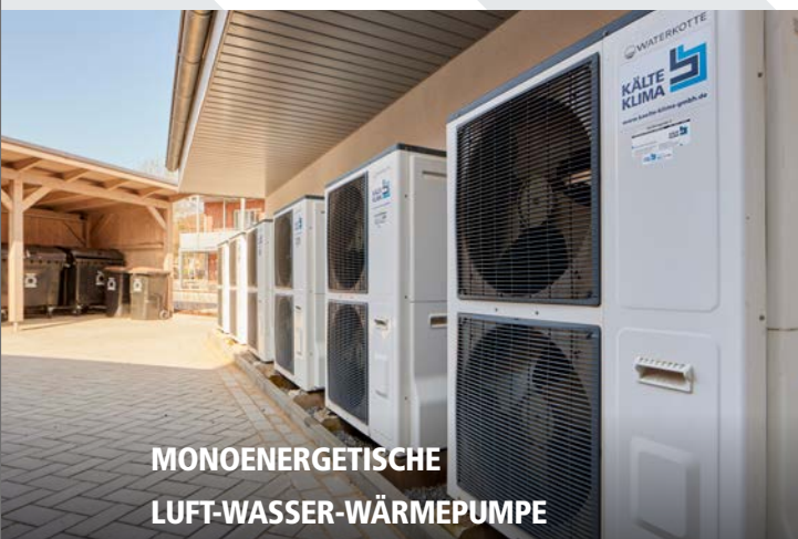
ZENTRALE WÄRMEVERSORGUNG EINER WOHNANLAGE
